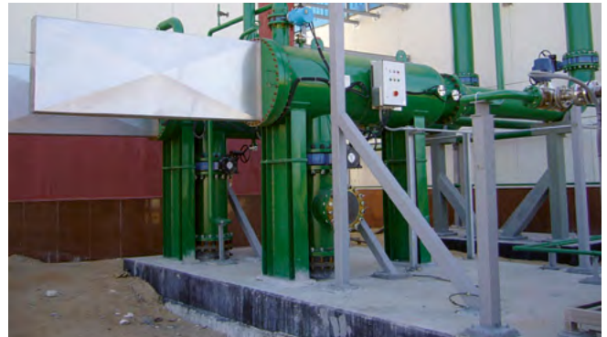
24"/DN 600 KAF® Filter – Meerwasser Kühlung
