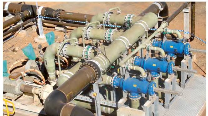
3 x 16"/DN 400 KAF® Filter – Entsalzungsanlage
